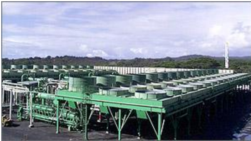
Μονάδα ηλεκτροπαραγωγής συνδυασμένου κύκλου ατμού και δυναμικού συστήματος στη Χαβάη των ΗΠΑ
