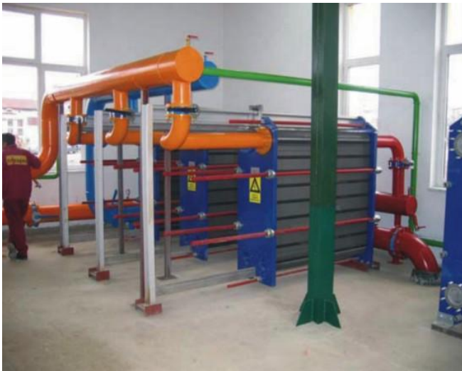
Τηλεθέρμανση με τη χρήση γεωθερμίας στη Βόρεια Ιοσία της Oradea της Ρουμανίας (πλακοειδείς εναλλάκτες θερμότητας)
