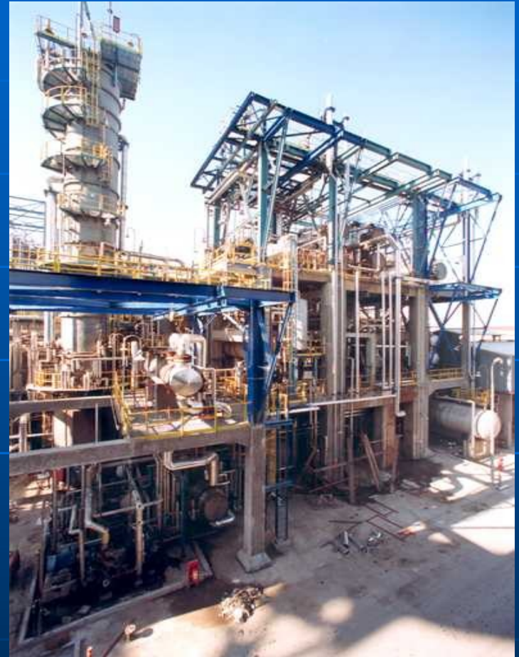
Μονάδα ισομερισμού & υδρογονοπυρόλυσης
