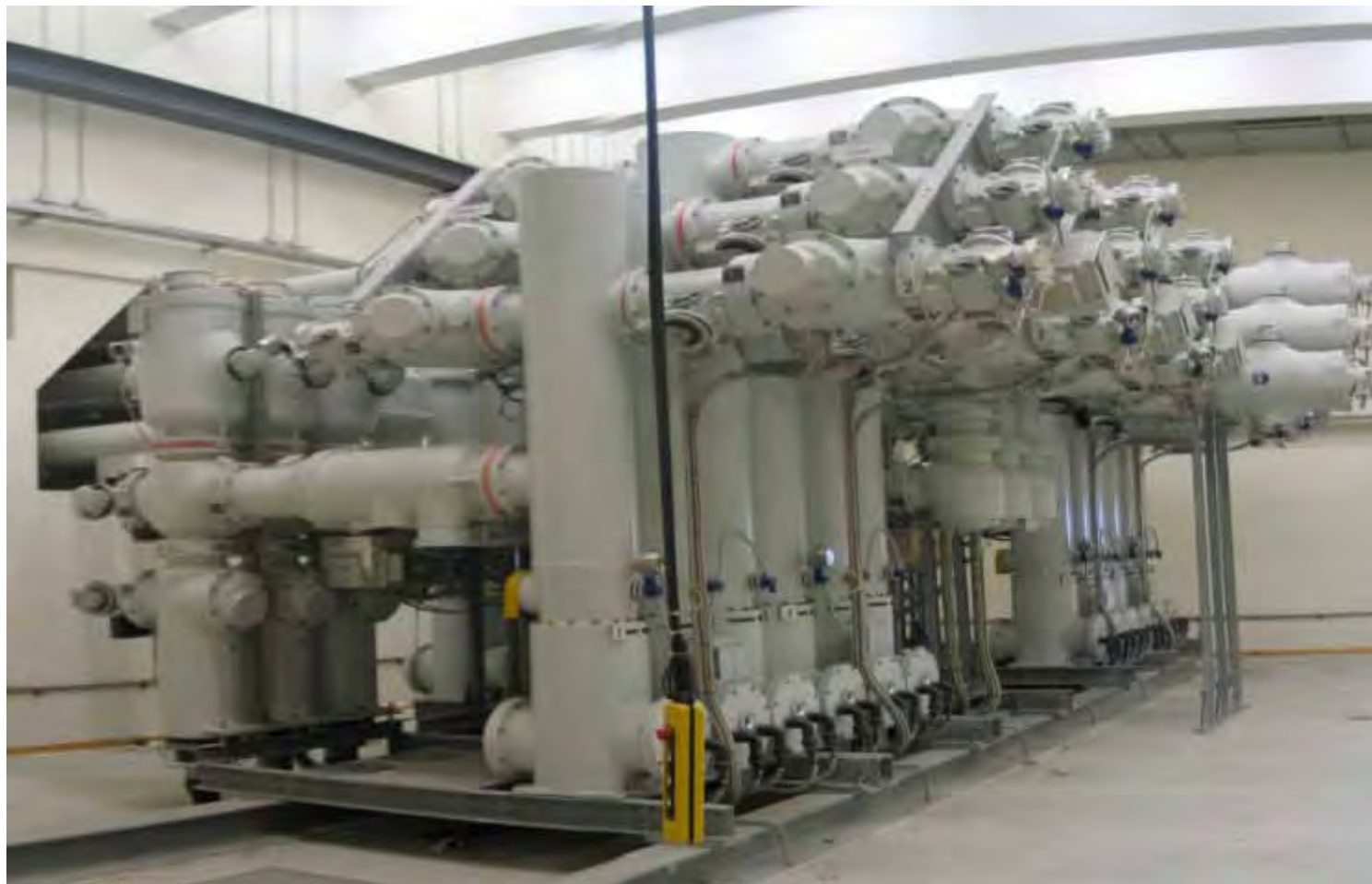
Άποψη κυψελών και ζυγών 150kV τύπου GIS
